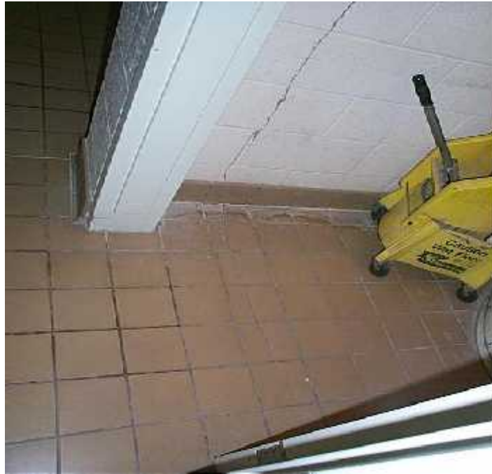
Gambar 2. Garis retak di sisi dinding bangunan menuju ke lantai ubin
