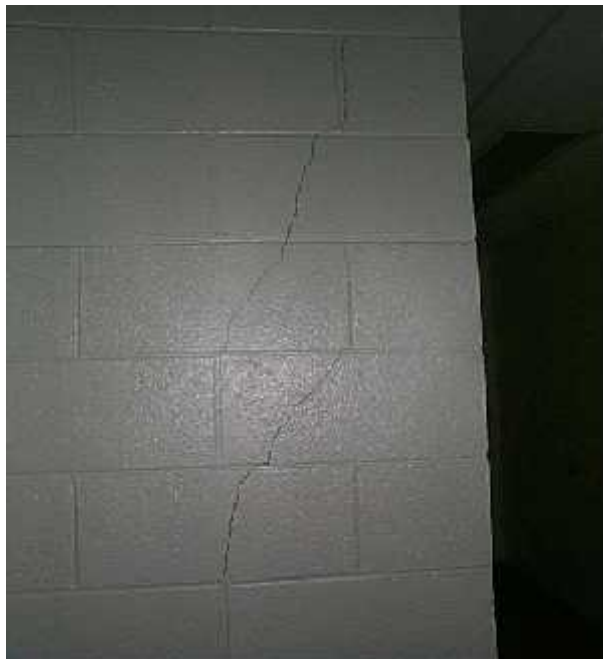
Gambar 1. Retak di dinding bangunan
