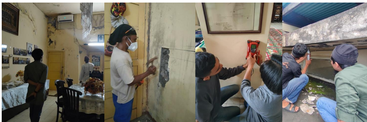
Gambar 2. Proses survei untuk mengetahui kerusakan-kerusakan yang terjadi di Kedaton Kesultanan Ternate (foto tim, 2023).
