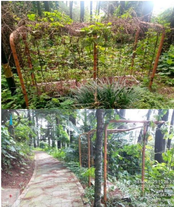
Gambar 3. Fasilitas yang tidak terawat
