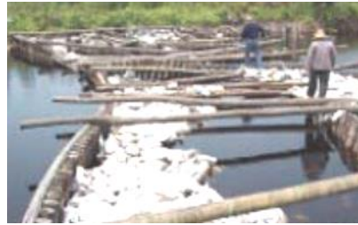
a) Deformasi konstruksi sekat
