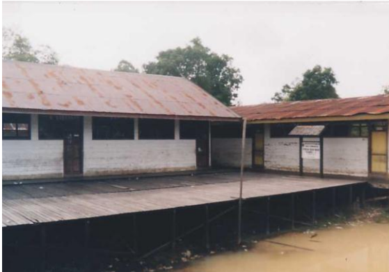
Gambar 20. Fasilitas Pendidikan yang ada di Kawasan Pahandut Seberang (sumber: Observasi, 2017).
