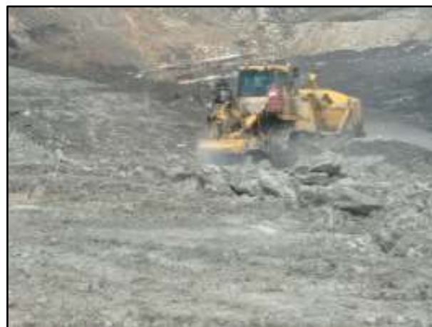
Gambar 3. Kondisi Material Ripping
