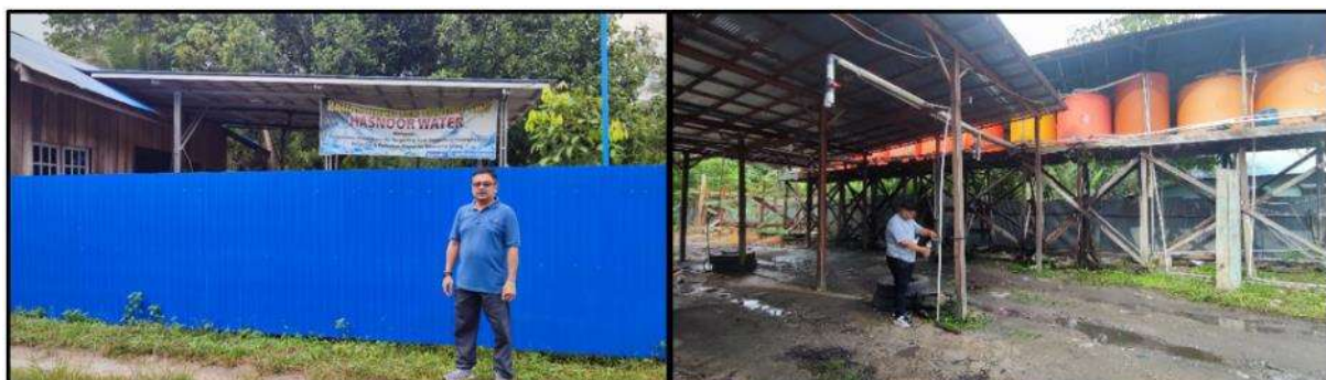
Gambar 4. Lokasi Pengisian Tangki Air Bersih dari Sumber Air Tangkiling untuk Depot Air Palangka Raya
