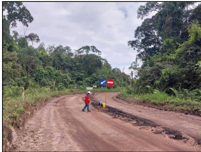
Gambar 6. Kondisi Separator pada Tikungan dan Persimpangan Jalan Tambang
