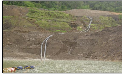
Gambar 4. Belokan Pipa Multiflo 420
