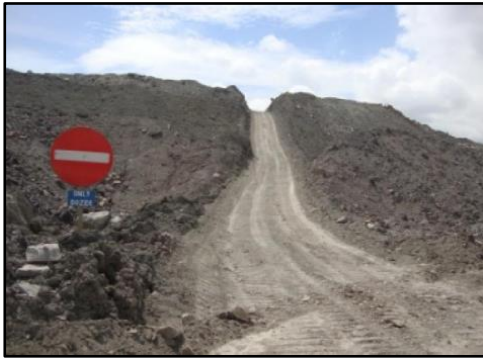
Gambar 8. Akses jalan terlalu terjal
