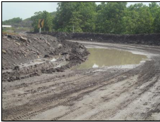
Gambar 4. Kondisi tergenang pada daerah tikungan
