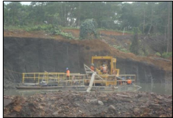
Gambar 6. Crew pompa tidak menggunakan jaket pelampung
